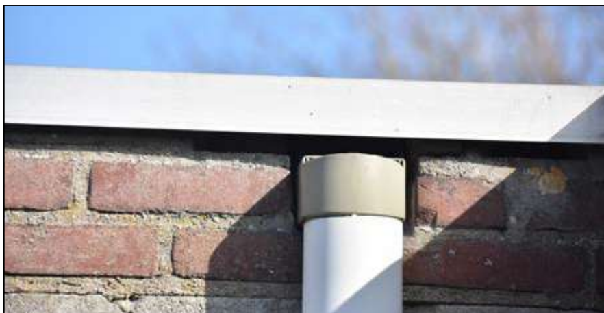
Figuur: de regenpijp aan de zijkant van de garageboxen. Hier zijn kieren en openingen aanwezig die mogelijk toegang verschaffen tot een verblijfplaats van vleermuizen.
