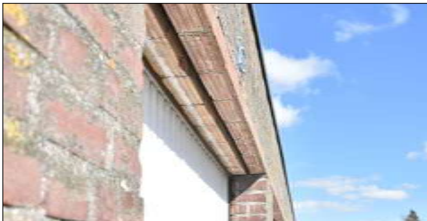
Figuur: boven de deuren van de garages zijn spleten aanwezig die mogelijk als verblijfplaats van vleermuizen dienen.
