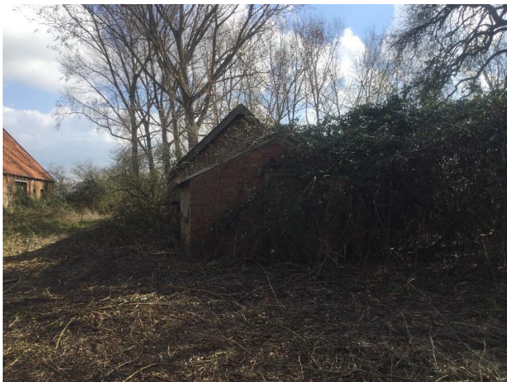
Foto 10 Schuur met asbestverdachte dakplaten (druppelzone)
