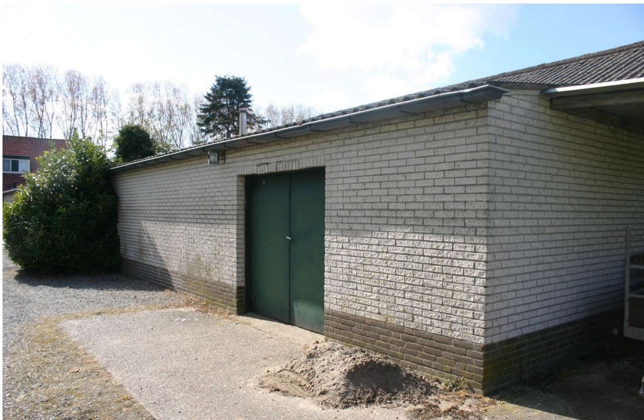
Figuur 4.4.3. Het zuidelijk deel van het bijgebouw bevat spouw, maar open stootvoegen etc. zijn afwezig.
