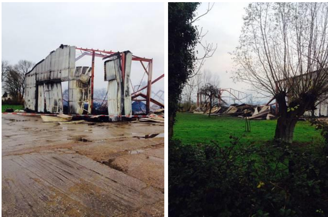
Figuur 5: Foto's plangebied na brandschade
