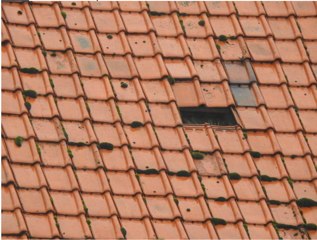
Foto 6 Ontbrekende dakpannen met ruimte voor vleermuizen.
