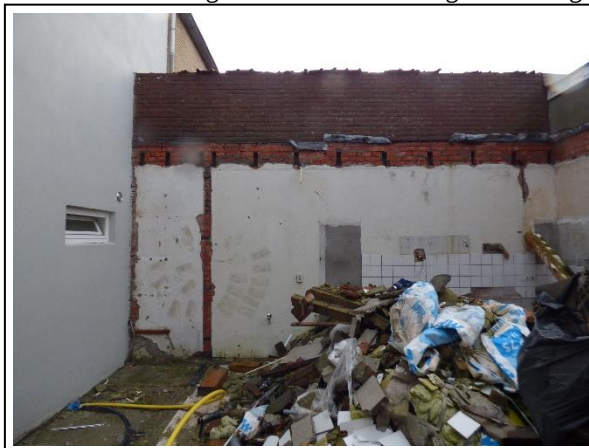
Foto 4 voormalige locatie keuken met gaten in de gevel
