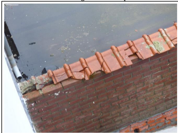
Foto 5 ontbrekende of gebroken dakpannen
