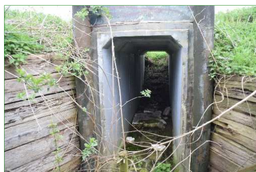
Vervallen toegangstunnel naar hut.
