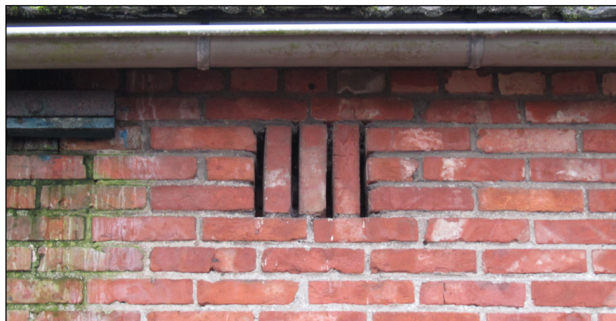
Figuur: de luchtspouw van het bijgebouw is toegankelijk door open stootvoegen. De open stootvoegen zijn circa 1,5 cm breed, waardoor deze te smal zijn voor laatvlieger.
