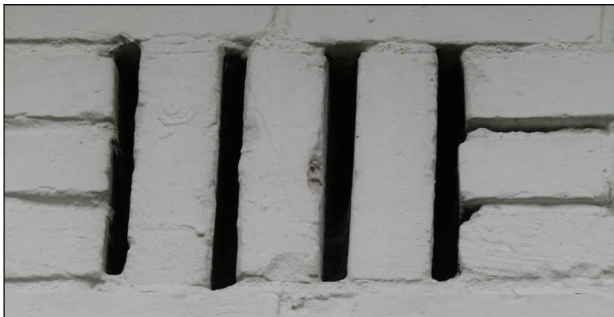
Figuur: het bijgebouw heeft op vier plaatsen open stootvoegen welke gebruikt kunnen worden door vleermuizen. Door de geringe breedte van de openingen (1,5 cm) zijn ze niet geschikt voor laatvlieger.
