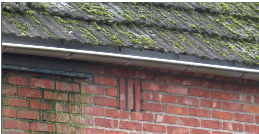
Figuur: de platte dakpannen van het bijgebouw zijn ongeschikt voor huismus.
