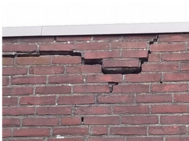
Afbeelding 3: Scheur in gevel, diep ingesleten. Ook is er ruimte onder de dakstrip aanwezig. Foto: V. Stuit | Ecoresult B.V.
