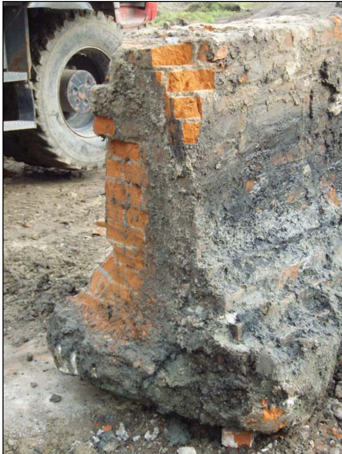
Afbeelding 29. Restant van de fundering van het voormalige tankstation.
