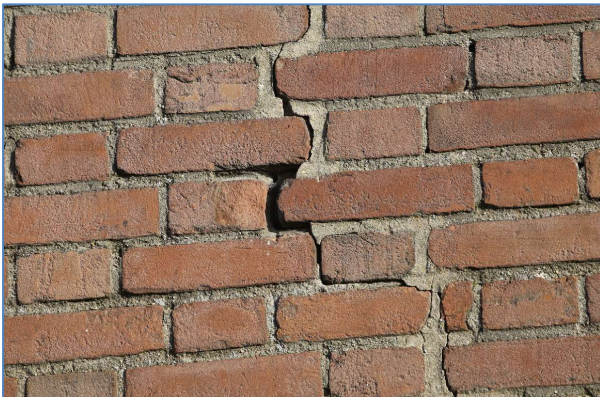
Het scheurtje blijkt bij nadere inspectie te ondiep voor vleermuizen (en hangt bovendien vol met spinnenwebben).
