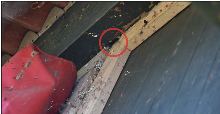
Figuur: er zijn diverse kleine openingen aanwezig die mogelijk toegang verlenen tot mogelijke verblijfplaatsen van vleermuizen.
