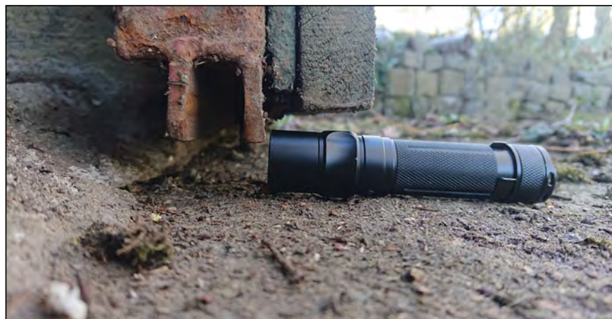
Figuur: er is ruimte onder de schuurdeur. Hier kunnen zorgplichtsoorten, zoals verscheidene muizensoorten, onderdoor kruipen.
