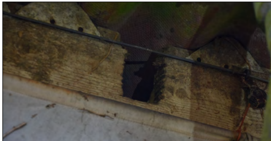
Figuur: op enkele plekken zijn openingen onder de dakrand. Door deze openingen is de ruimte tussen de golfplaten en het piepschuim van buitenaf te bereiken. Hier zijn mogelijk verblijfplaatsen van vleermuizen aanwezig.
