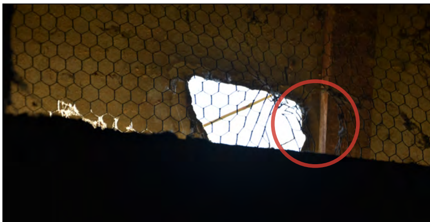
Figuur: bij een van de ramen is een gat in het kippengaas ontstaan waardoor marters de schuur binnen kunnen komen.
