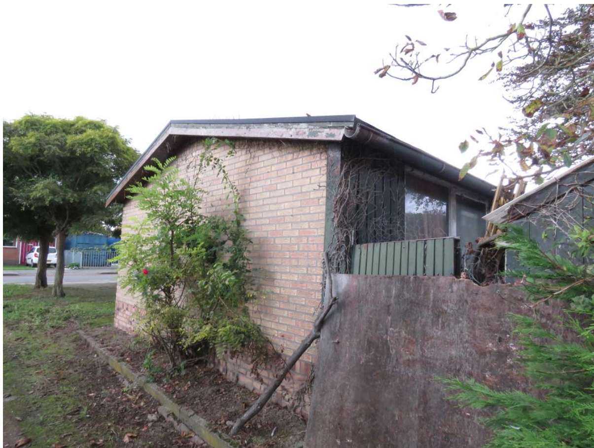
Figuur 8: Spleten en kieren zijn in de gevels afwezig. Foto: G. Tanis | Ecoresult B.V.
