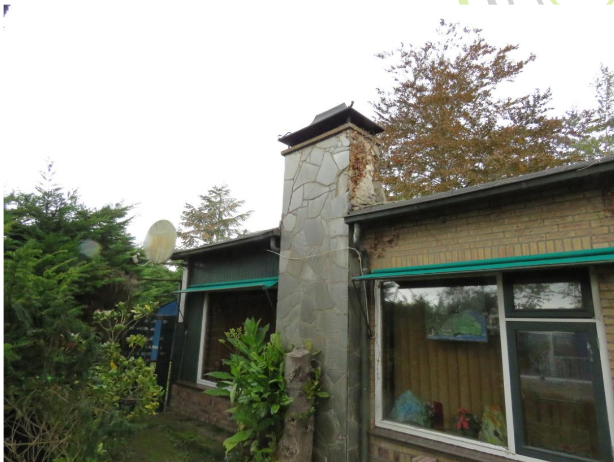
Figuur 9: Spleten en kieren zijn in de gevels en schoorsteen afwezig. Foto: G. Tanis | Ecoresult B.V.
