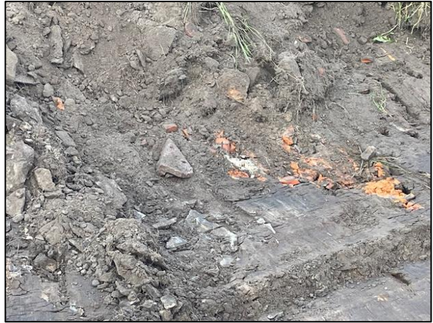
Foto 2. Asbestplaatmateriaal aangetroffen tijdens uitvoering sanering
