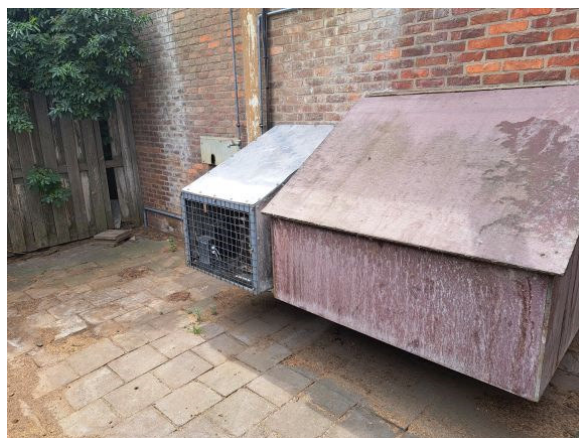
Foto 3.2.10 Compressor koelwater en inlaat compressorruimte
