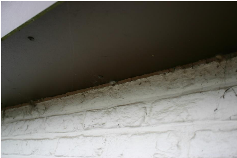
Figuur 4.4.2. Tussen de gootbetimmering en de buitengevel van het woonhuis is nergens een kier aanwezig.
