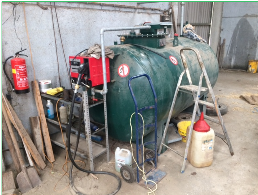
Foto 5: Bovengrondse dieseltank in grote schuur
