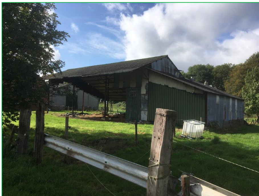
Foto 4: Vervallen schuur met asbestdak zonder hemelwaterafvoer
