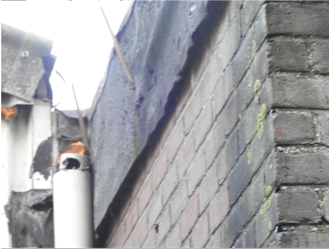
Foto 5. Kierende gevelbeplating (vleermuis).
