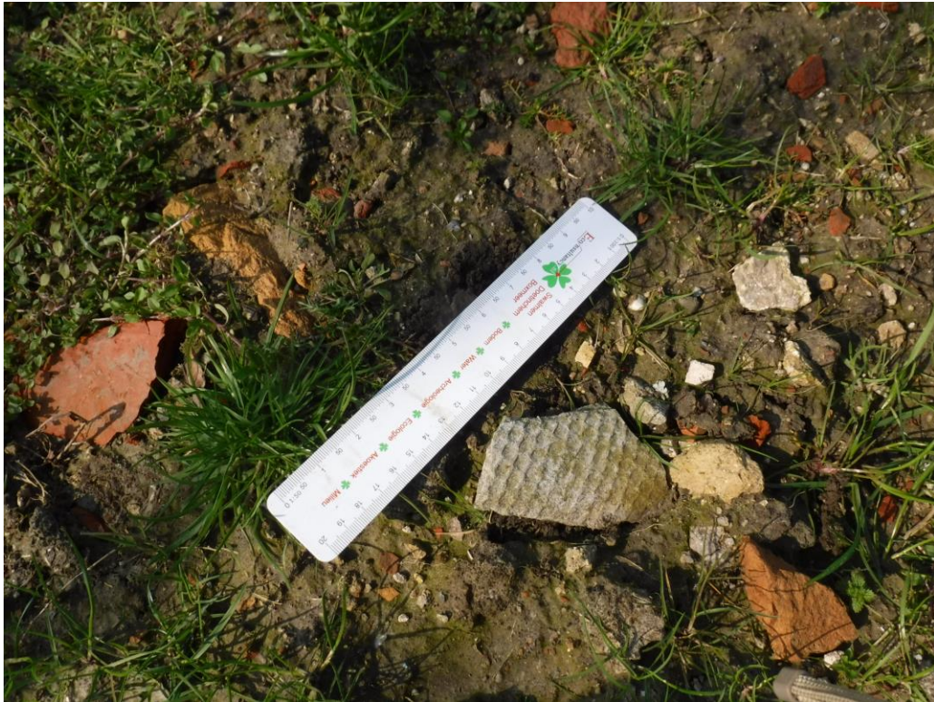
Foto 9 (asbestverdacht plaatmateriaal: ASB-1).
