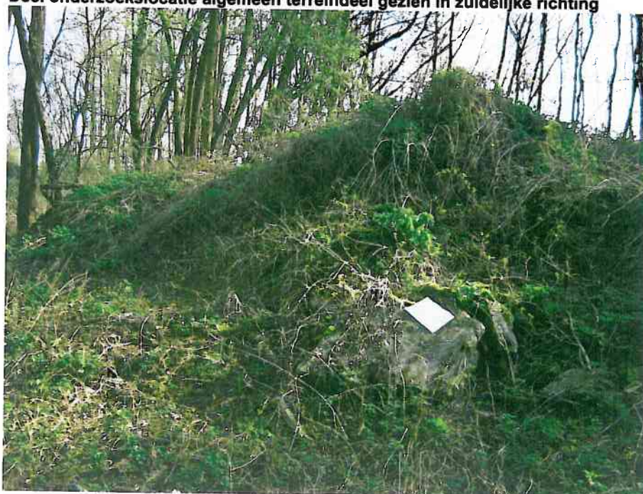
Deel grond/puinwal. Grof puin is aanwezig.
