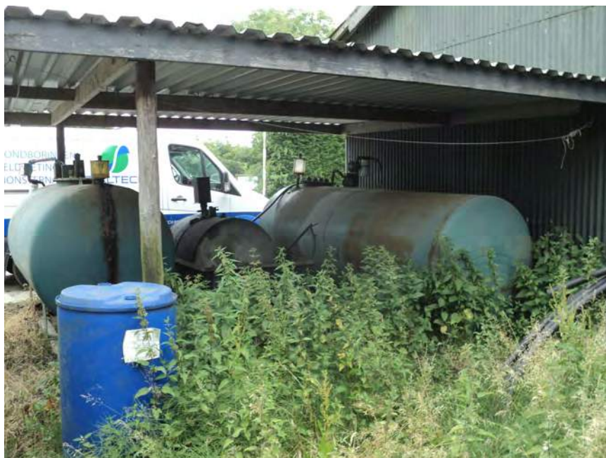
Foto DSC_03205 achteraanzicht deellocatie 1: bovengrondse opslagtanks
