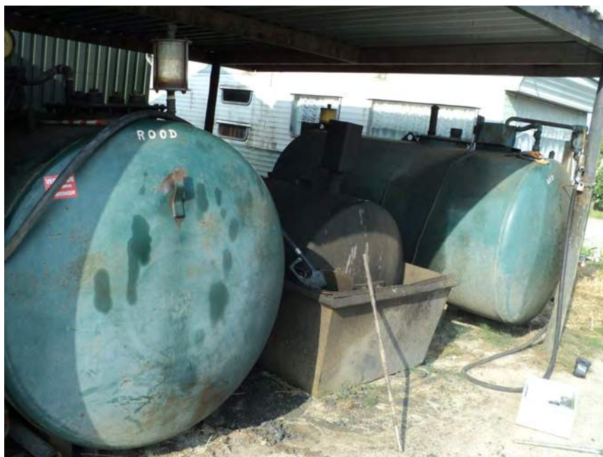
Foto DSC_03194 vooraanzicht deellocatie 1: bovengrondse opslagtanks
