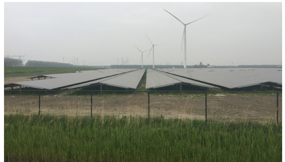
Het zonnepark ten zuiden van het plangebied, met lage panelen in oost-west opstelling
