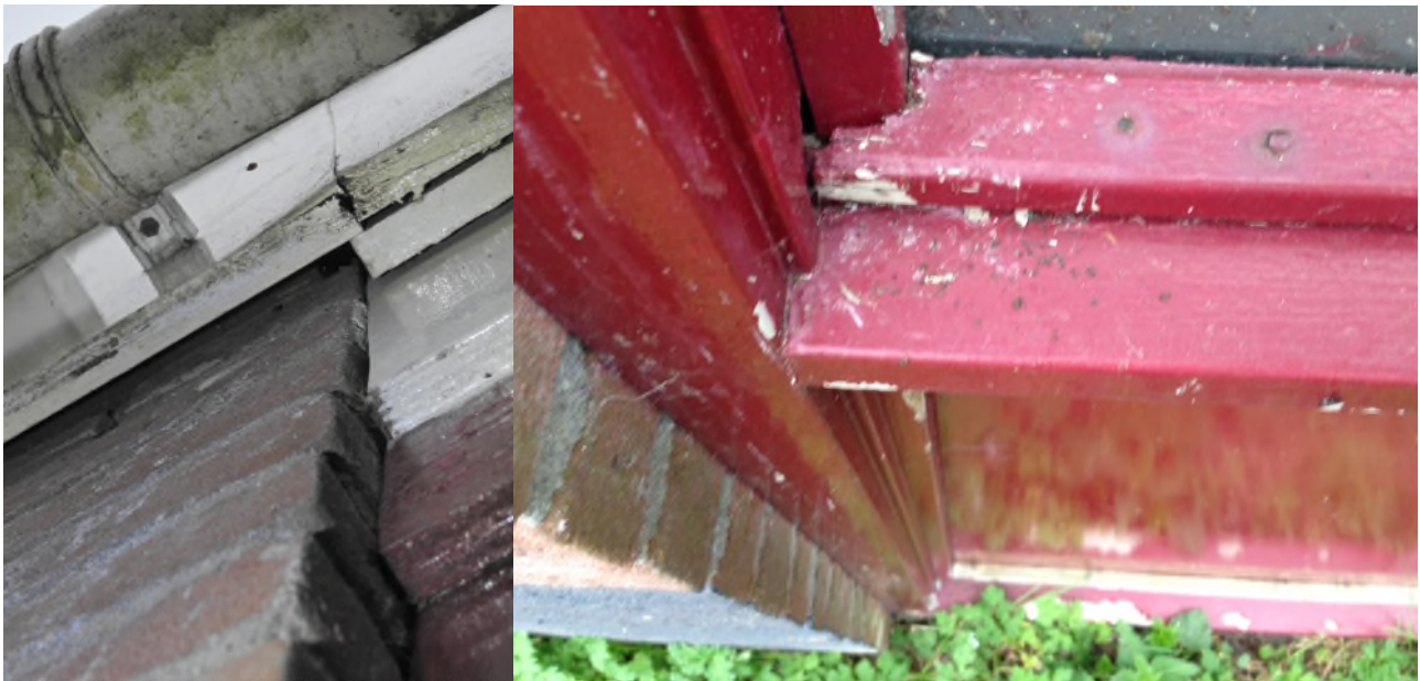
Figuur 4: uitwerpsel(resten) in/onder mogelijke invliegopening van te slopen pand
