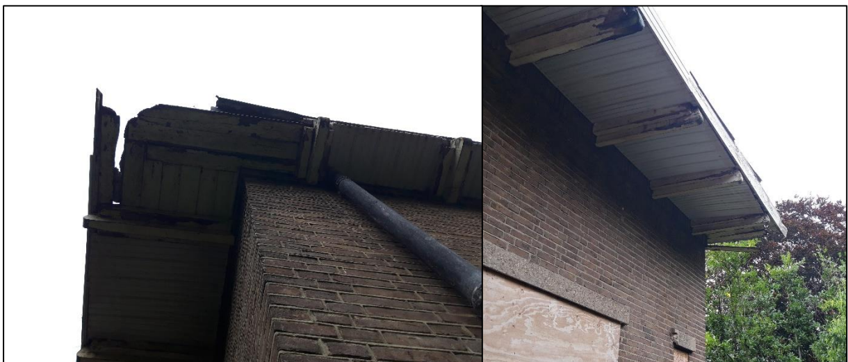
Afbeelding 4.1. Verrotte en versleten dakbeschot biedt wegkruipmogelijkheden voor vleermuizen
