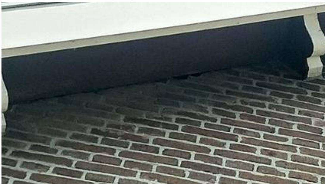
Afbeelding 7: Kieren tussen de buitenmuur en dakoversteek welke geschikt zijn als mogelijke verblijfplaats voor huismus en gierzwaluw. Foto: M. de Vries | Ecoresult B.V.
