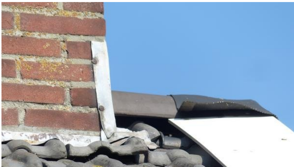
Detail van de achterzijde van het de nok van het dak van het woonhuis binnen het plangebied. Er zijn kieren aanwezig onder het waterbord en de nokpannen van het dak welke gebruikt kunnen worden door huismussen. Foto: M. de Vries | Ecoresult B.V.
