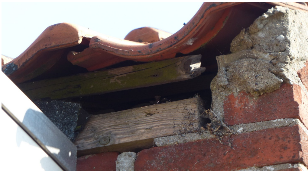
Detail van de achterzijde van het bedrijfspand binnen het plangebied. Er zijn kieren aanwezig tussen de buitenmuur en het dak welke gebruikt kunnen worden door huismussen. Foto: M. de Vries | Ecoresult B.V.
