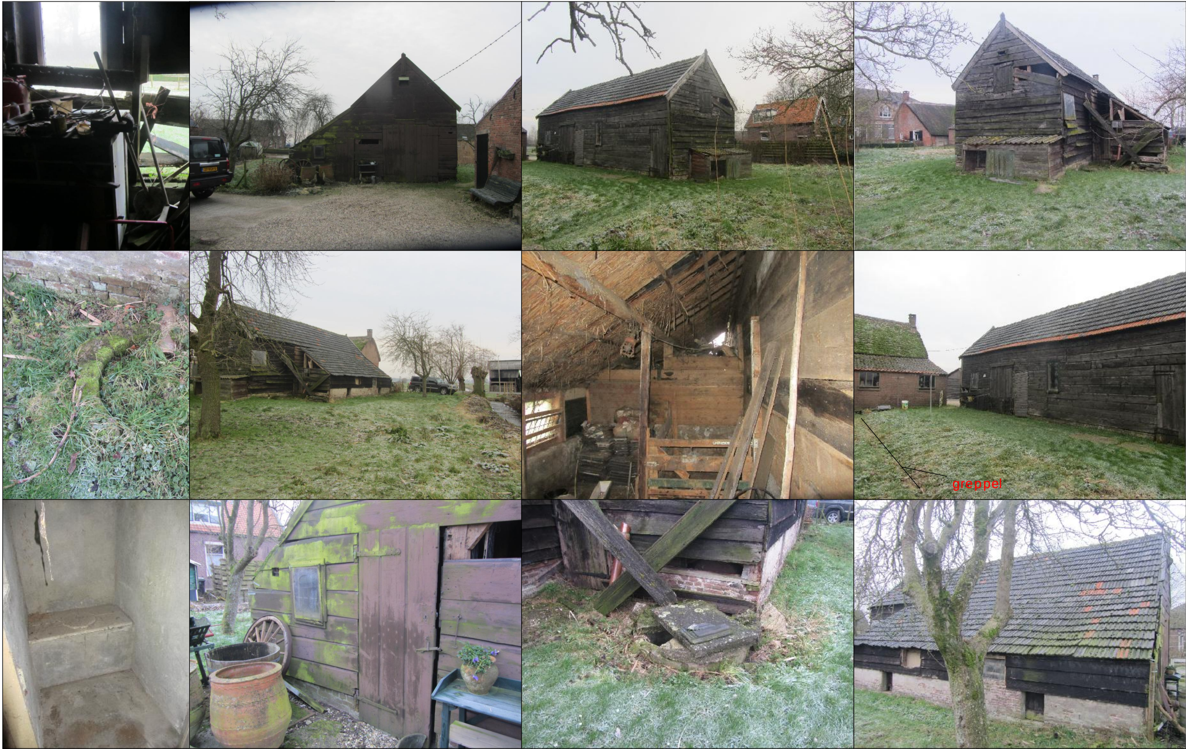
vervallen schuur Slingelandseweg 24 direct naast monumentale boerderij, onderdeel ensemble
