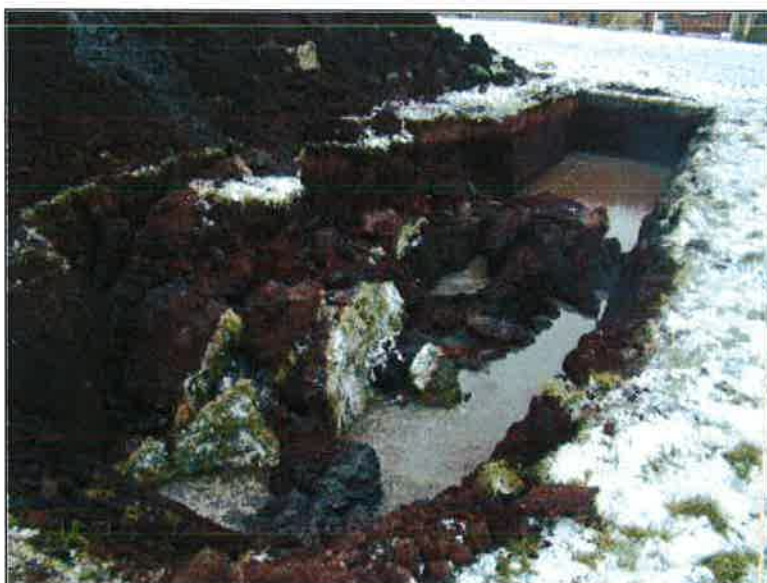
Afbeelding 10. Proefsleuf 4. Overlast door opwellend grondwater en instabiele en ingestorte profielwand.
