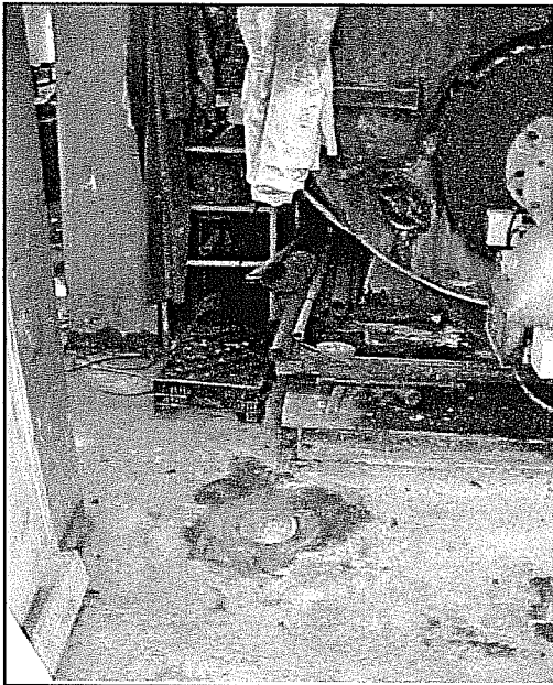
Foto 2 Verwarmingsketel in ketelhuis
