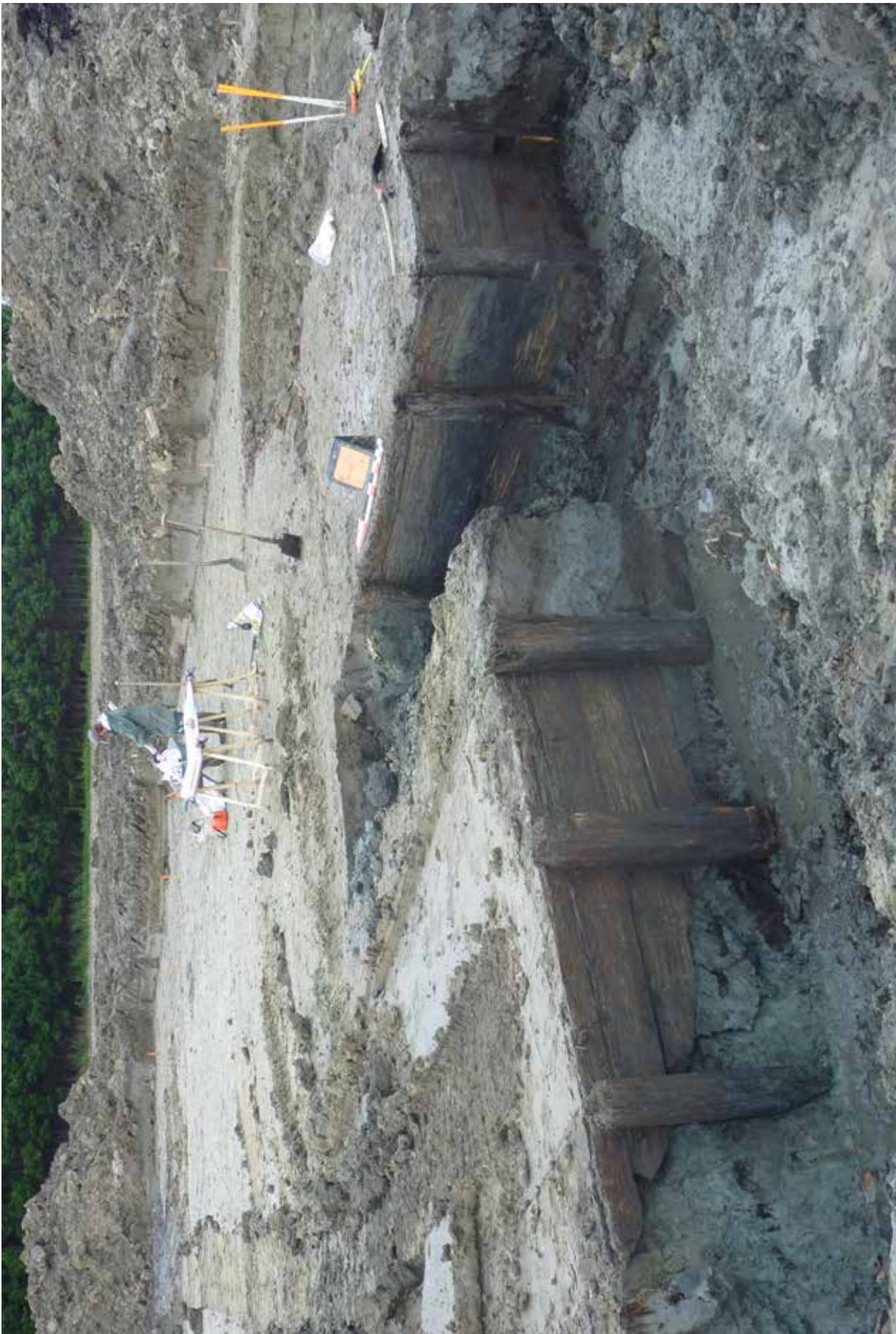
Fig. V - 12 De houtenbeschoeiing loopt binnen de gracht volledig om de aarden blokken heen.
