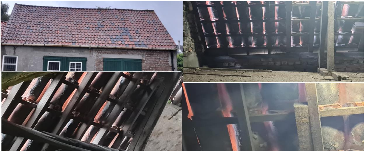
Afbeelding 4: Her en der op het dakvlak zijn pannen die toegang geven tot mogelijke verblijfplaatsen van vleermuizen, huismus en gierzwaluw. Aan de binnenzijde is echter geen dakbeschot, waardoor er geen verblijven van deze soorten aanwezig zijn in de schuur.
