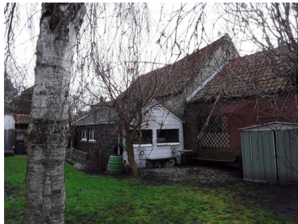
Bij de achtergevel is een berging aanwezig met asbestverdachte golfplaten.
