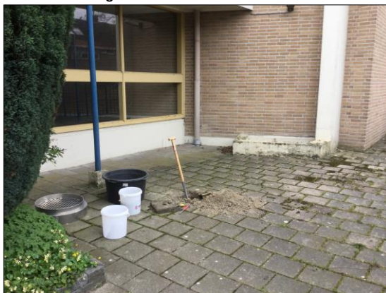
Foto 8 Asbestgat (d.d. 28 maart 2019)
