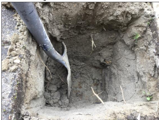
Foto 7 Asbestgat (d.d. 28 maart 2019)
