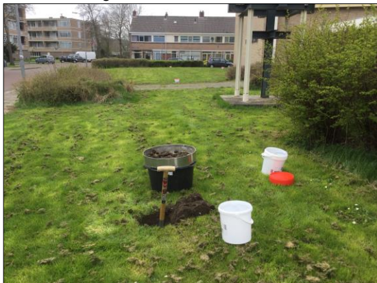
Foto 9 Asbestgat (d.d. 28 maart 2019)
