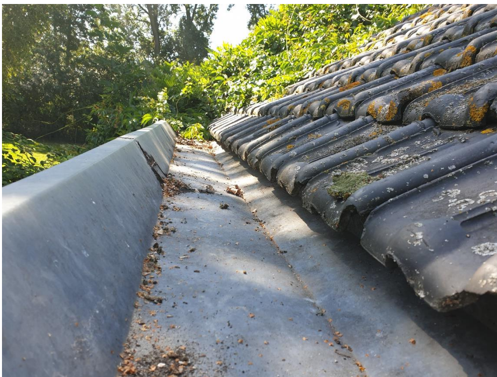
Foto 8. Dakgoot oostzijde pand 2
