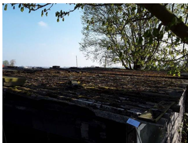
Dak losse schuur
