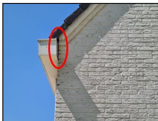
Afbeelding 6: Ruimte achter dakgoot / onder kantpan
