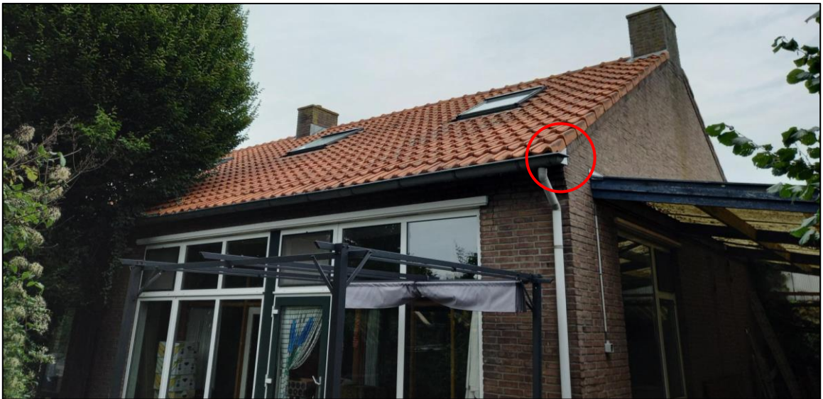
Foto 3: Impressie van het pannendak van de woning, waarbij de openingen op de hoek bij de onderste rij dakpannen is afgedicht (rood omlijnd).
