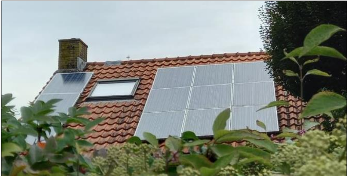
Foto 6: Zonnepanelen op het dak van de woning.
