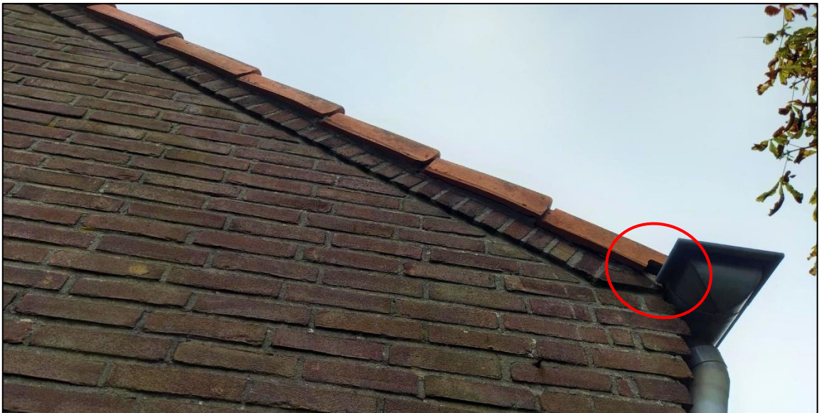
Foto 4: Ruimtes tussen dakpannen en gevel zijn dichtgemetseld, de enige ruimte/opening is aanwezig op de hoek bij de dakpan op ongeveer 2,5 meter hoogte (rood omlijnd).
