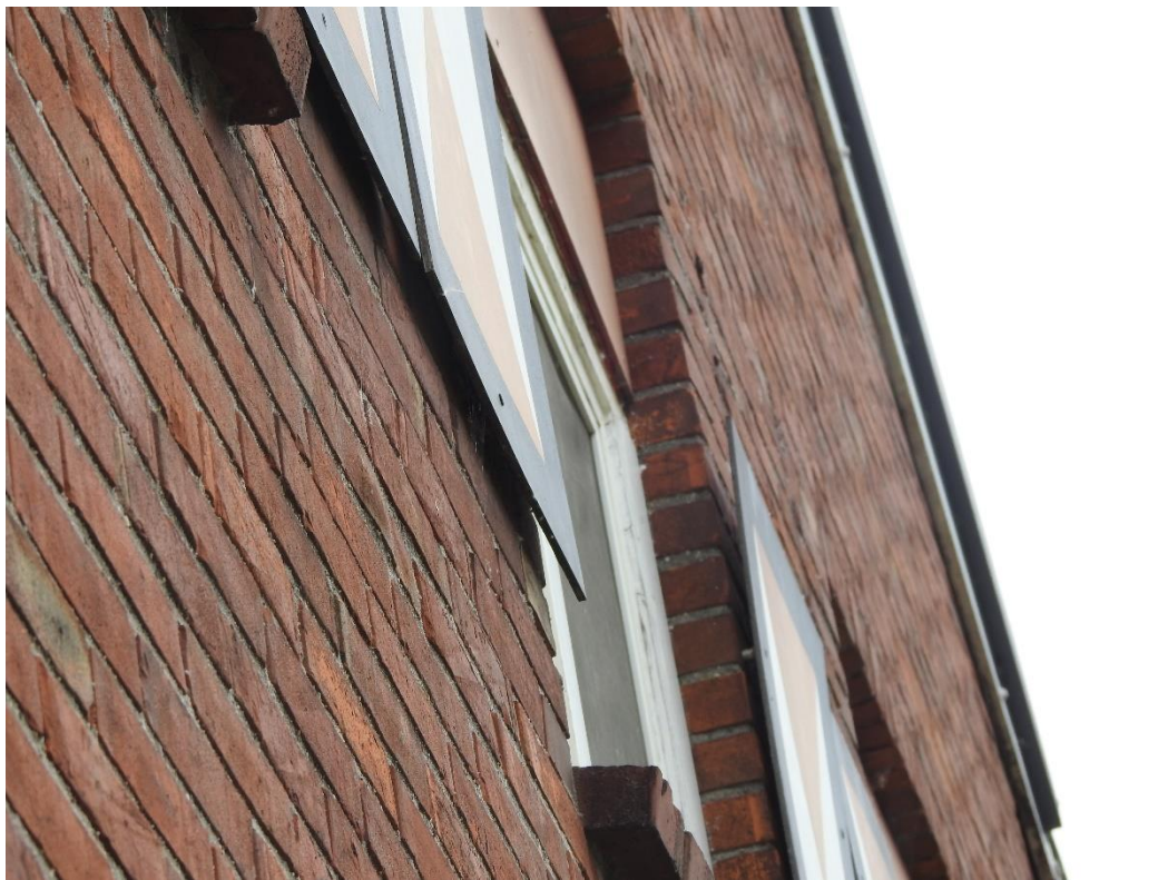
Foto 3. Verblijfplaatsen gewone dwergvleermuis achter gevelbeplating.
