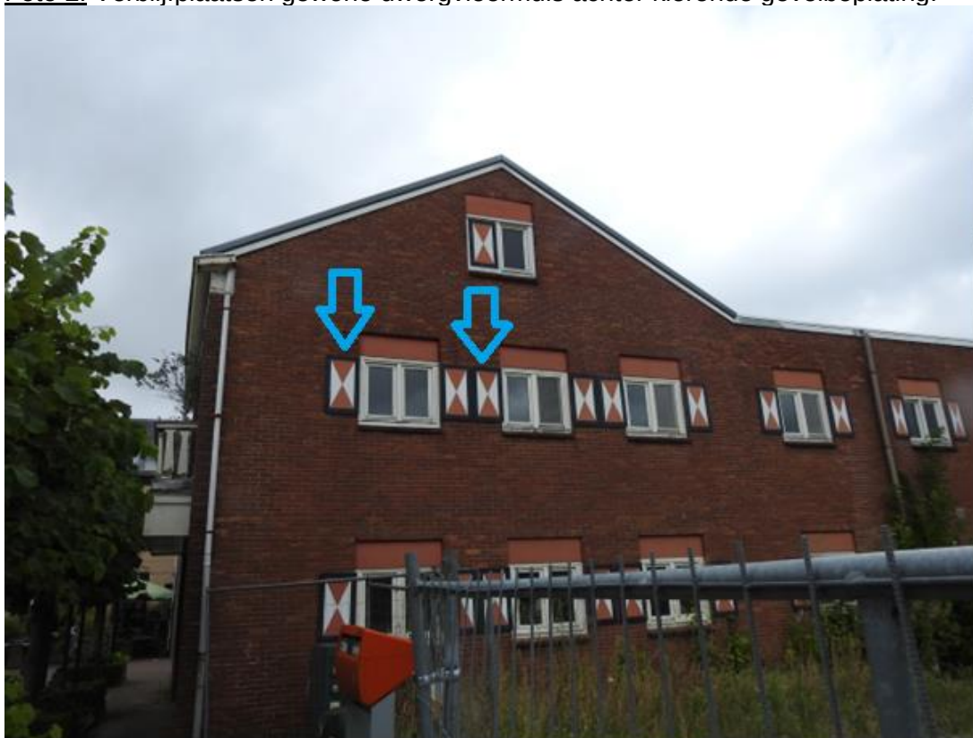
Foto 2. Verblijfplaatsen gewone dwergvleermuis achter kierende gevelbeplating.
