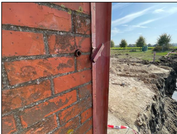
Foto 6: Afleverpunt voormalige dieseltank en restant leidingwerk Foto gemaakt op 10 oktober 2023
