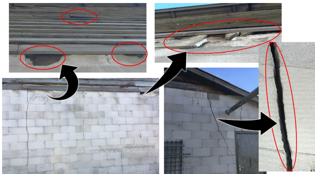
Figuur 2 Openingen welke toegang verschaffen tot de achterliggende ruimte (spouw), maar eveneens oorzaak zijn van een luchtverplaatsing in de spouw.
