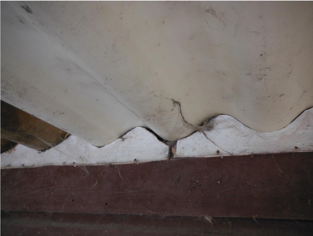
Vogelschroot NIET asbestverdacht
