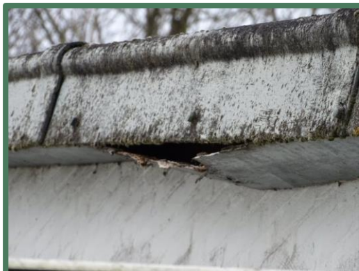
Afbeelding 19: Gat in het boeiboord van de bedrijfsloods Bron: quickscan Brabant Eco d.d. 9 februari 2024
