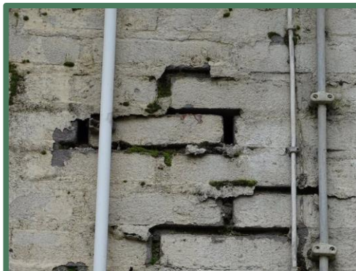
Afbeelding 20: Ontbrekende voegen, directe toegang tot de spouwmuur
