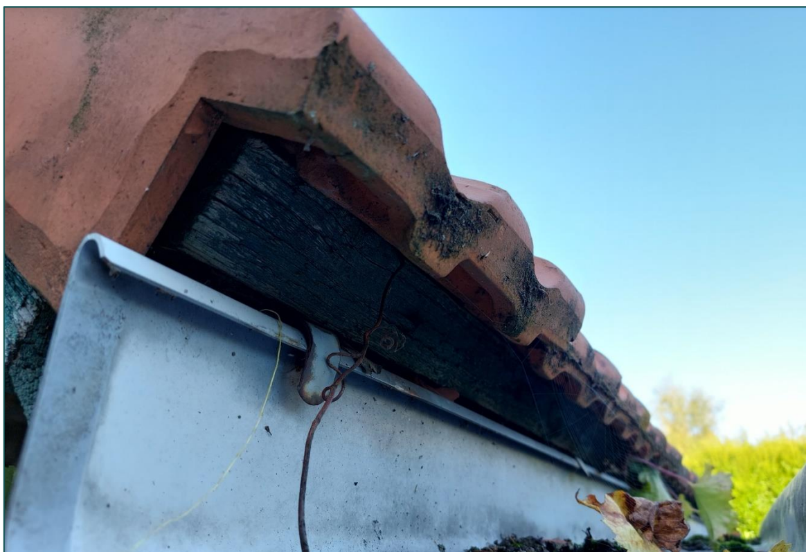
Figuur 4 Een balk ter hoogte van de dakvoet belemmert voor vogels als de huismus de toegang tot de dakruimte.
