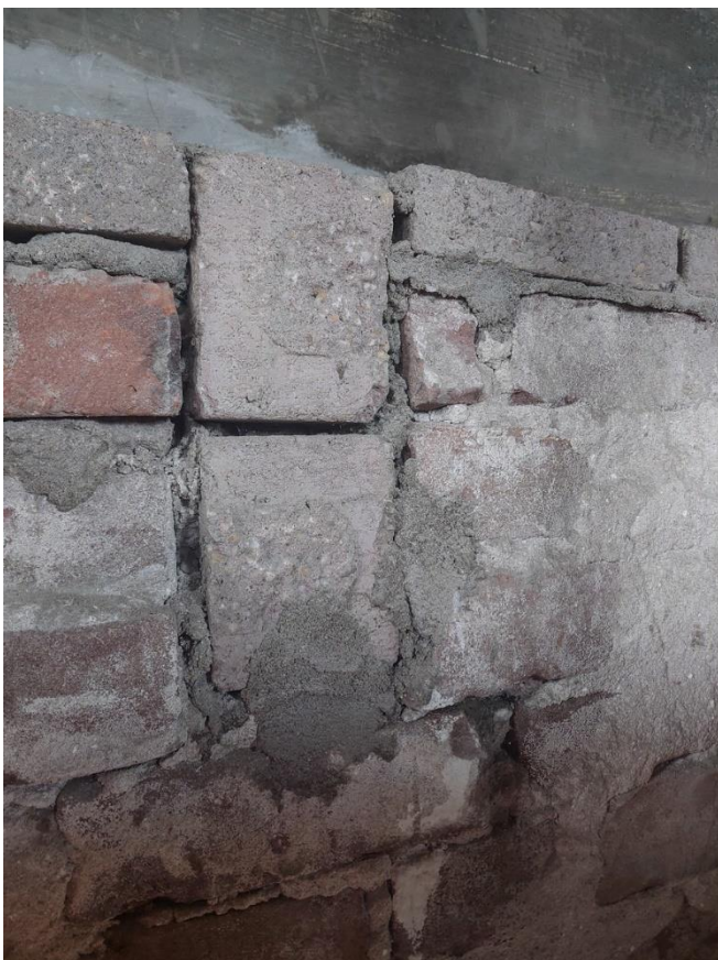
Dichtgezet balkkopgat dat bewijst dat het huidige trapgat niet oorspronkelijk is.
