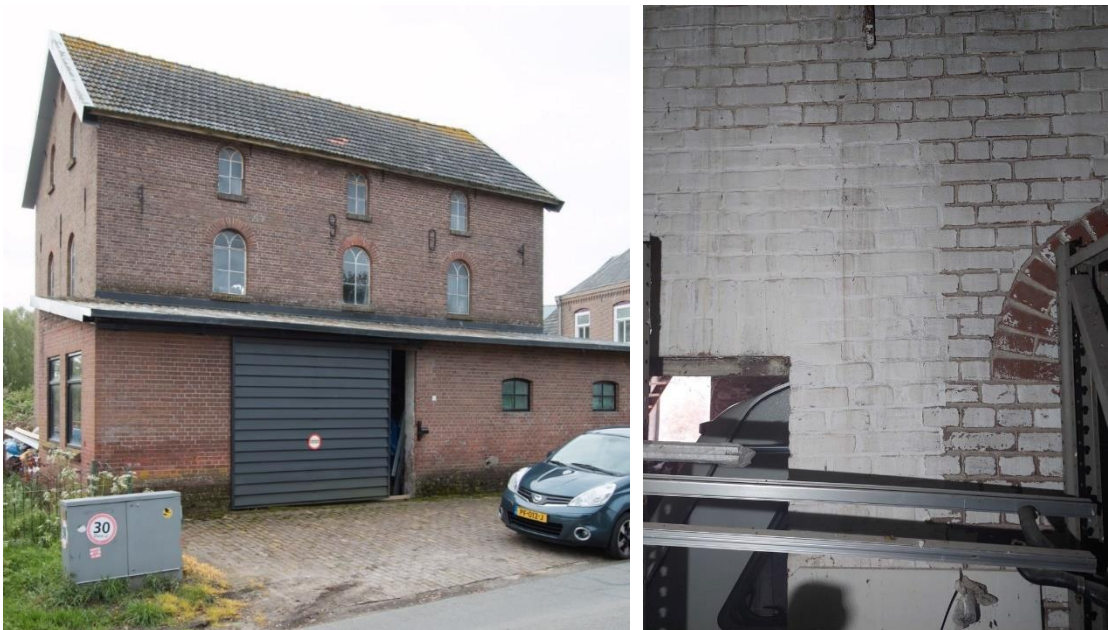
De voorgevel met latere aanbouw. Rechts schilderwerk over het schoonmetselwerk. Links de rollaag van de secundaire doorgang, rechts een aanzet van een oorspronkelijke rondboog van een vensteropening. Overzichtsfoto is niet mogelijk vanwege stellingkasten voor de gevel.
