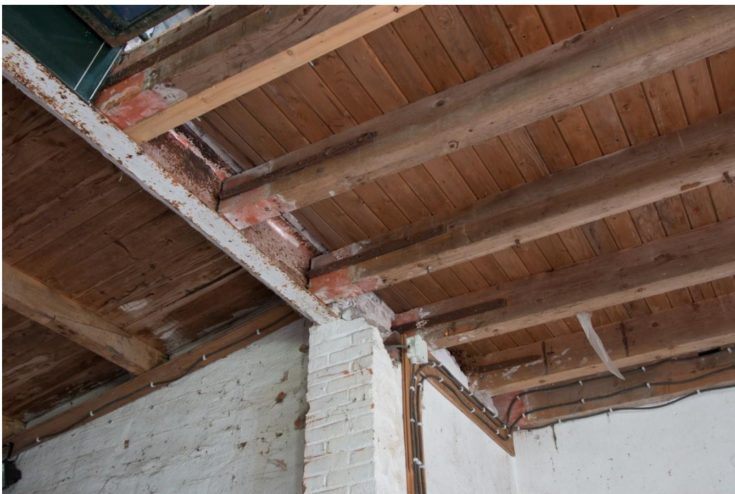
Opname waarop te zien is dat de binten ter plaatse van de grote doorgang in de voorgevel opgelegd zijn op een stalen balk. De balkkoppen zijn in de menie gezet. De witte uitslag op de balkkoppen (kalk) toont aan dat deze balken oorspronkelijk in muurwerk laten opgelegd. Dit bewijst dat de stalen balk (en dus de doorgang in huidige vorm) van latere datum is.
