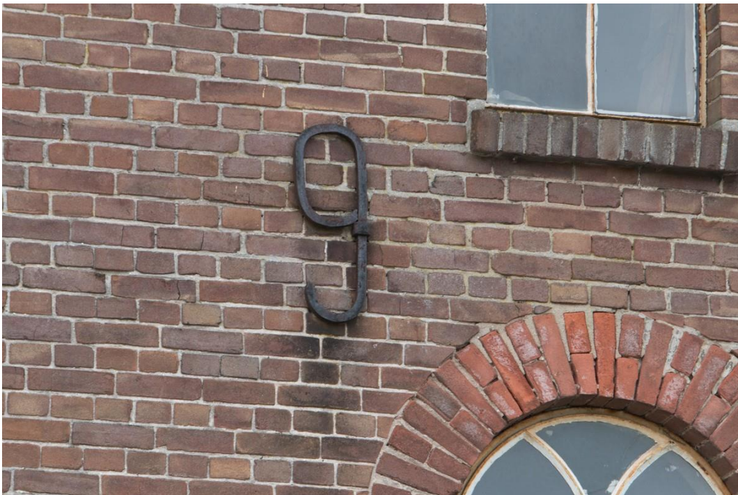
Eén van de oorspronkelijke cijferankers. De lekdorpel in beeld is vernieuwd.
