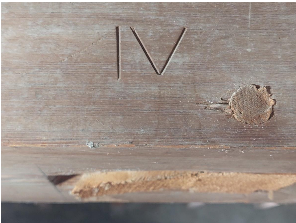
Het gehakte telmerk IV linksboven de toognagel waarmee het korbeel oorspronkelijk was vastgezet.
