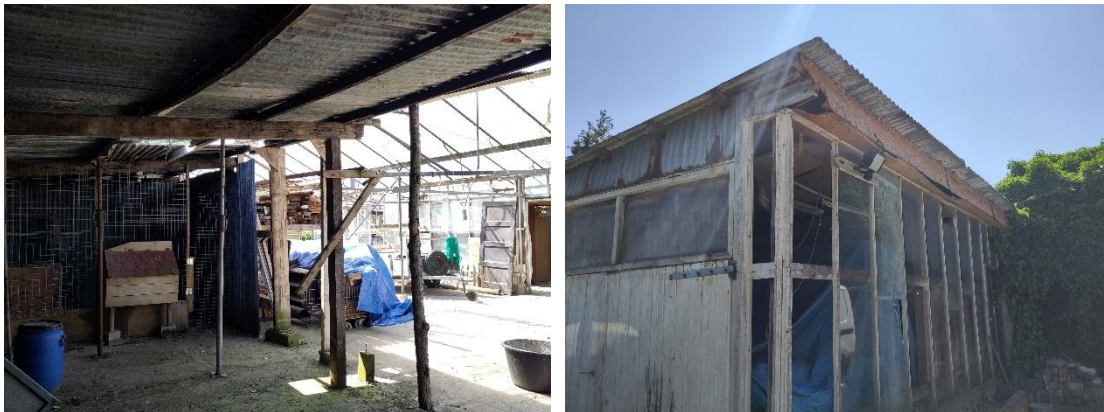
Afbeelding 2. Indruk van het plangebied met links het achterste deel bedekt met golfplaten bij het kippenhok. Ook hier is te zien dat houten pilaren rotten en zijn ondersteund. Rechts de hobby/bergruimte, ook met enkel laag golfplaten dak. Op de punt is een stuk open waar een paartje houtduif broedt.
