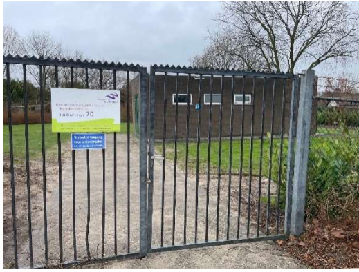
het rioolgemaal aan het Zand
