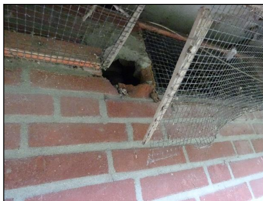
Figuur 16. Opening in schuurdeel 1 van nr. 61 met gebruikssporen van steenuil.
