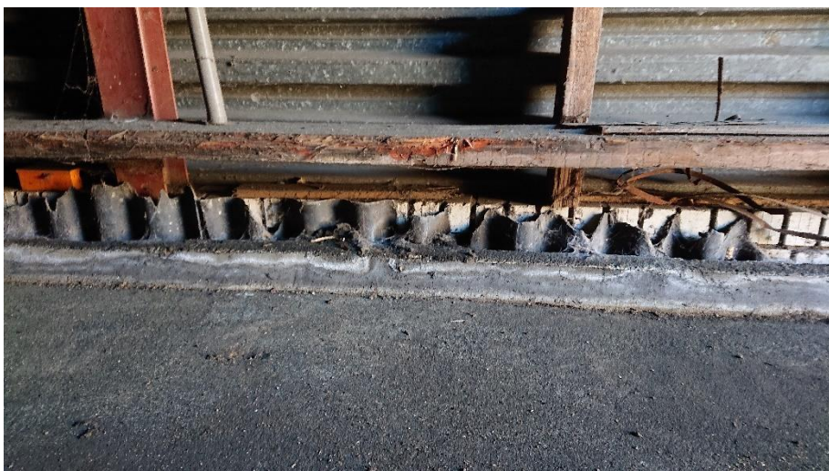
Asbestplaten in betonverharding
