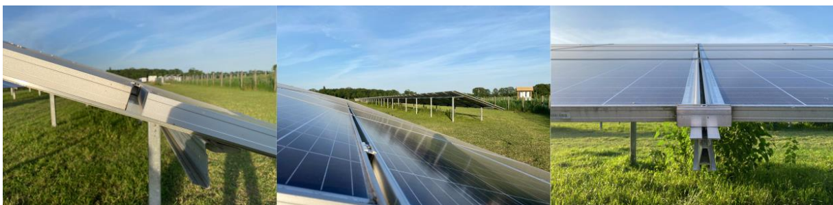
Afbeelding 16. Opstelling pv-panelen, waardoor voldoende ruimte is voor infiltratie regenwater (bron: Eelerwoude/TR)
