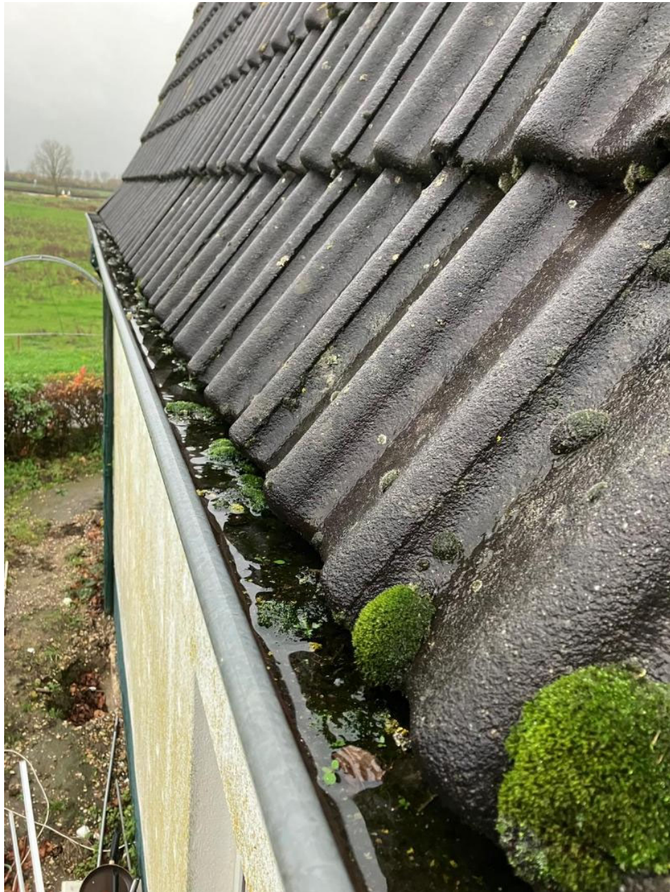
• Afbeelding 24: dakgoot voorzijde
