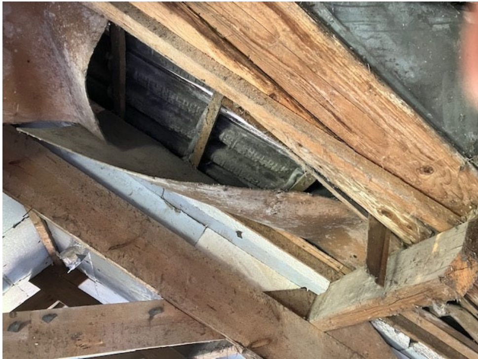
• Afbeelding 4: Dak van het woonhuis is op veel plekken lek
