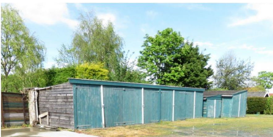
Figuur 2: de zes bouwvallige garages op het terrein (Bron foto: Ecoresult B.V.)
